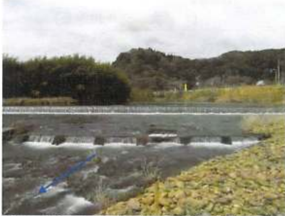
床止工 (h=0.9m) により連続性が分断され魚の遡上を妨げていた
