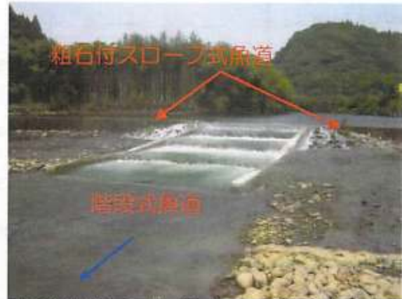
現況滞筋位置 (床止中央) に階段式魚道と粗石付スロープ式魚道を整備
